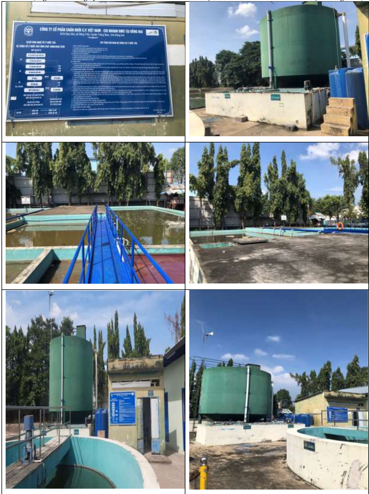
Hình 4. 10. Hệ thống xử lý nước thải, công suất 200 m 3 /ngày.đêm tại dự án
