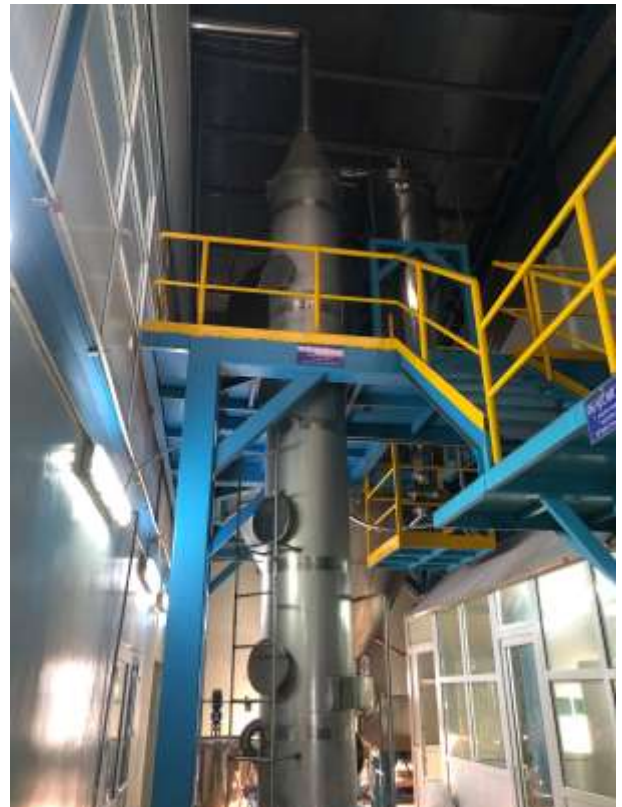
HTXL khí thải khu vực sấy 2 công suất
