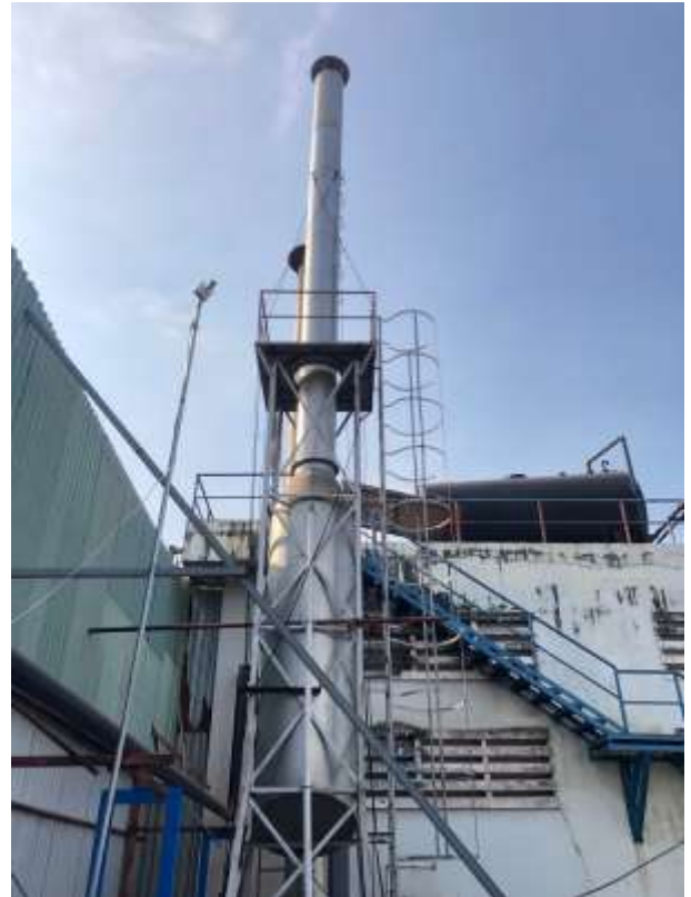
HTXLKT lò hơi 2 công suất 24.000 m 3 /giờ
