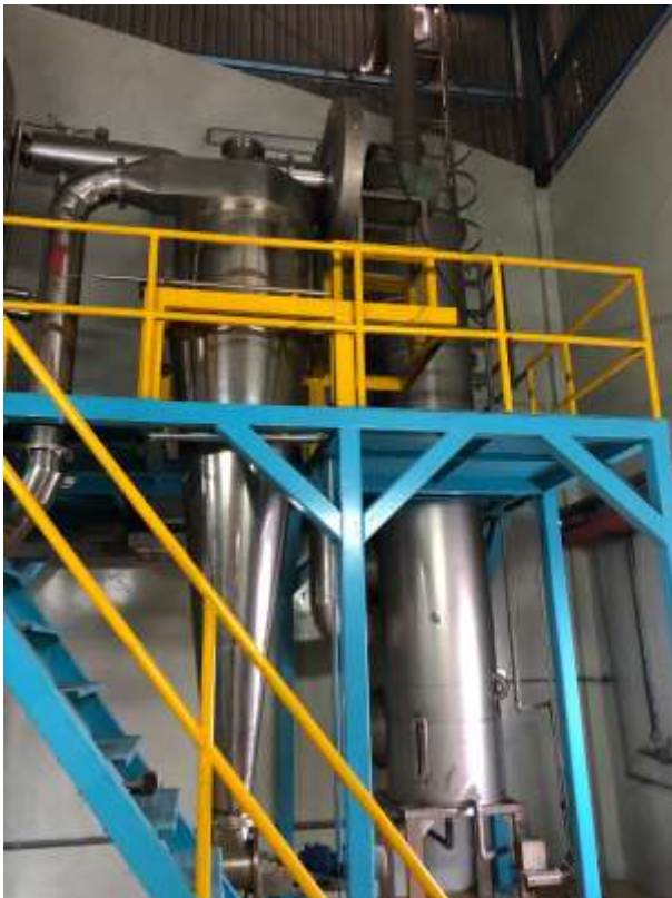
HTXL khí thải khu vực sấy 1 công suất
